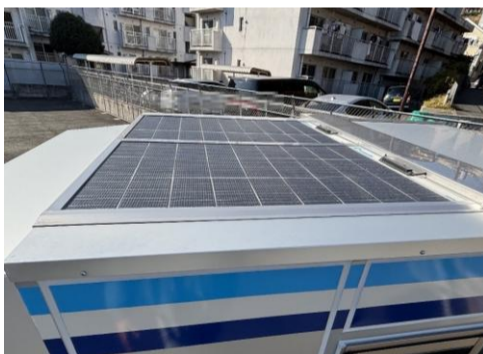
太陽光パネルを用いて電気を供給しCO 2 削減に貢献している
